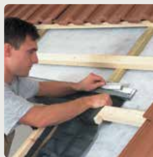
Посилений дренажний жолоб, який не потребує додаткової опори
